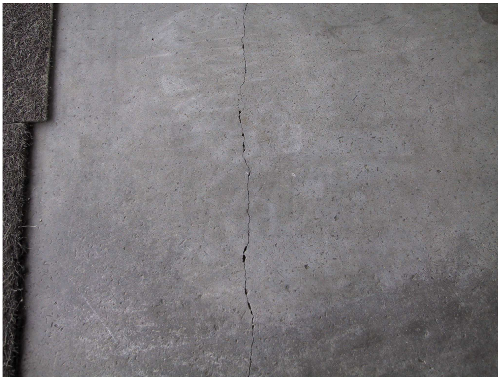
Alter, gerissener Zementestrich
